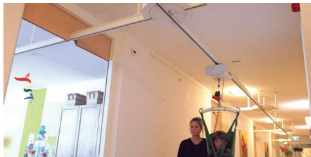
Monorailsysteem met rotonde en brandwerende deurdoorvoer.
