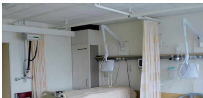
Ziekenhuiskamer meerbeds met traverse-systeem voorzien van gordijndoortvoer.
