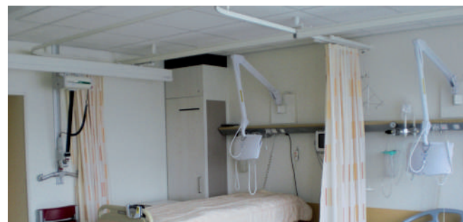
Ziekenhuiskamer meerbeds met traverse-systeem voorzien van gordijndoortvoer.
